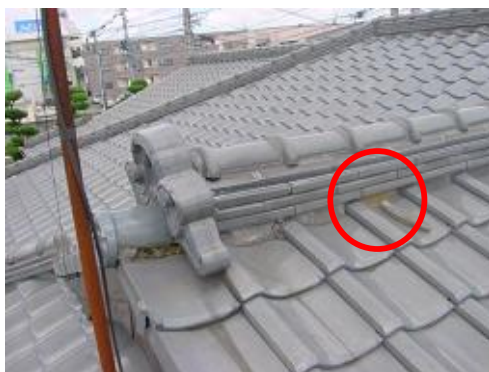
棟漆喰のはがれ
