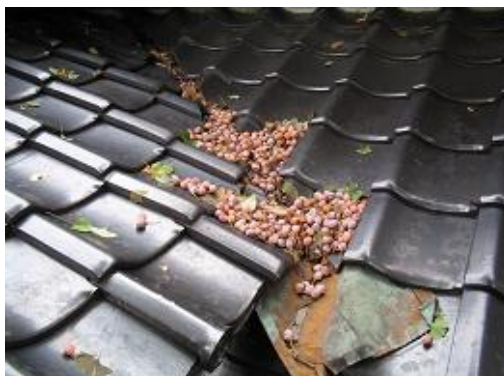
谷のゴミの詰り
